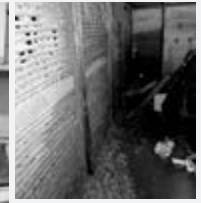
溶けてしまった土壁(真備町会員宅)
